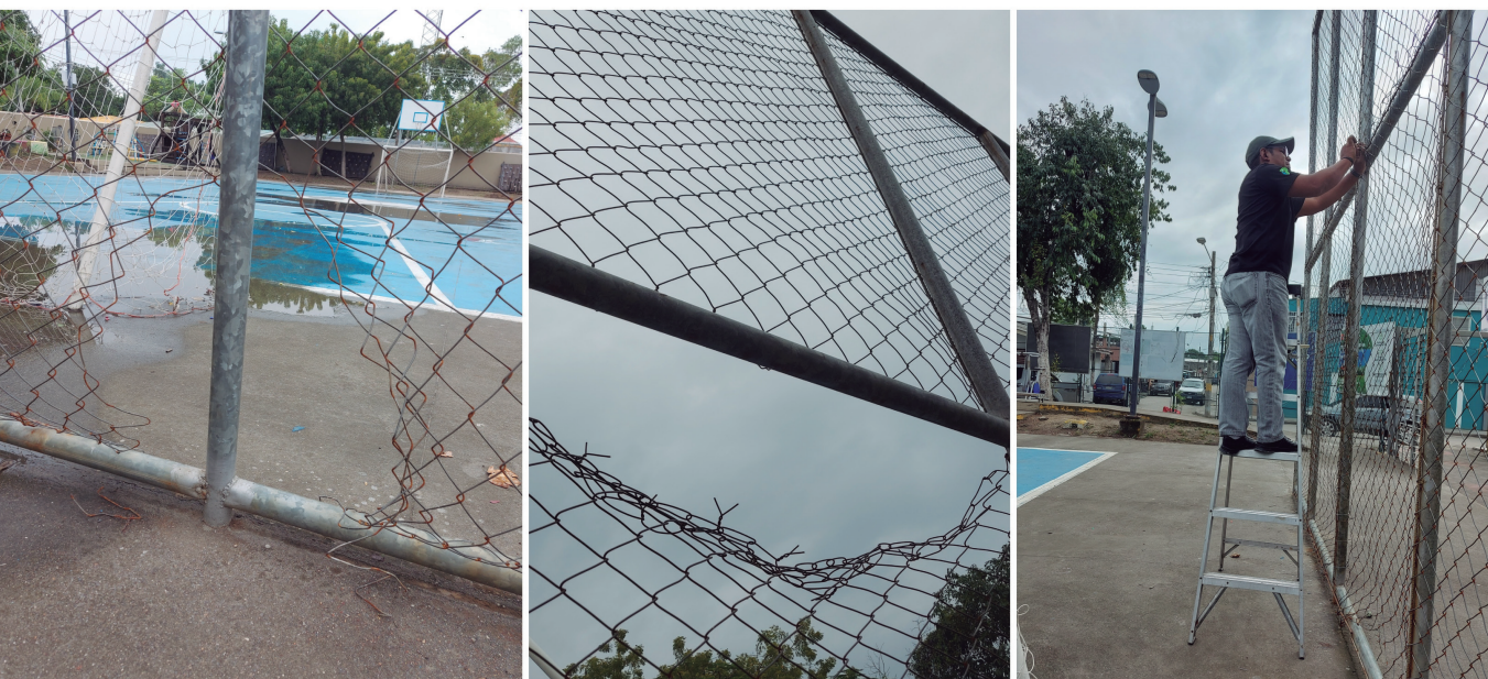
Se repararon algunas mallas del cerco de la cancha del Parque Rivera Hernández.
