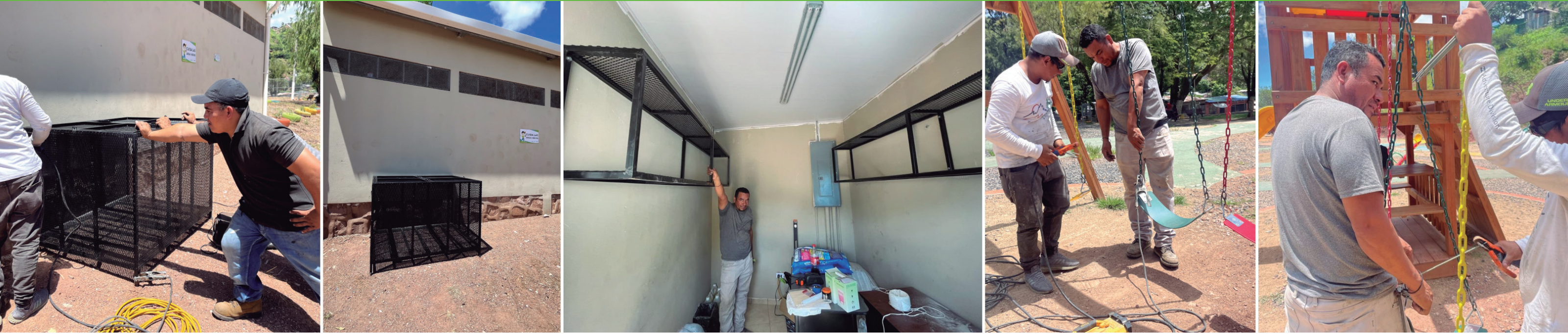
Se fabricó un contenedor de basura, estantes para la bodega y se repararon algunos columpios del Parque El Esfuerzo, Nueva Suyapa.
